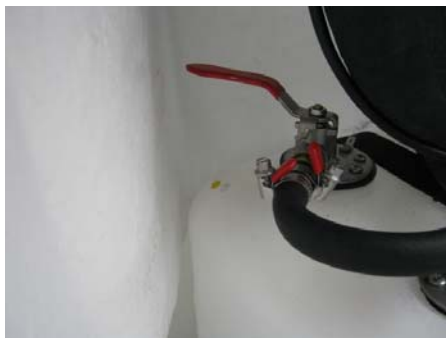
Vanne d'alimentation carburant : Située sur le réservoir
